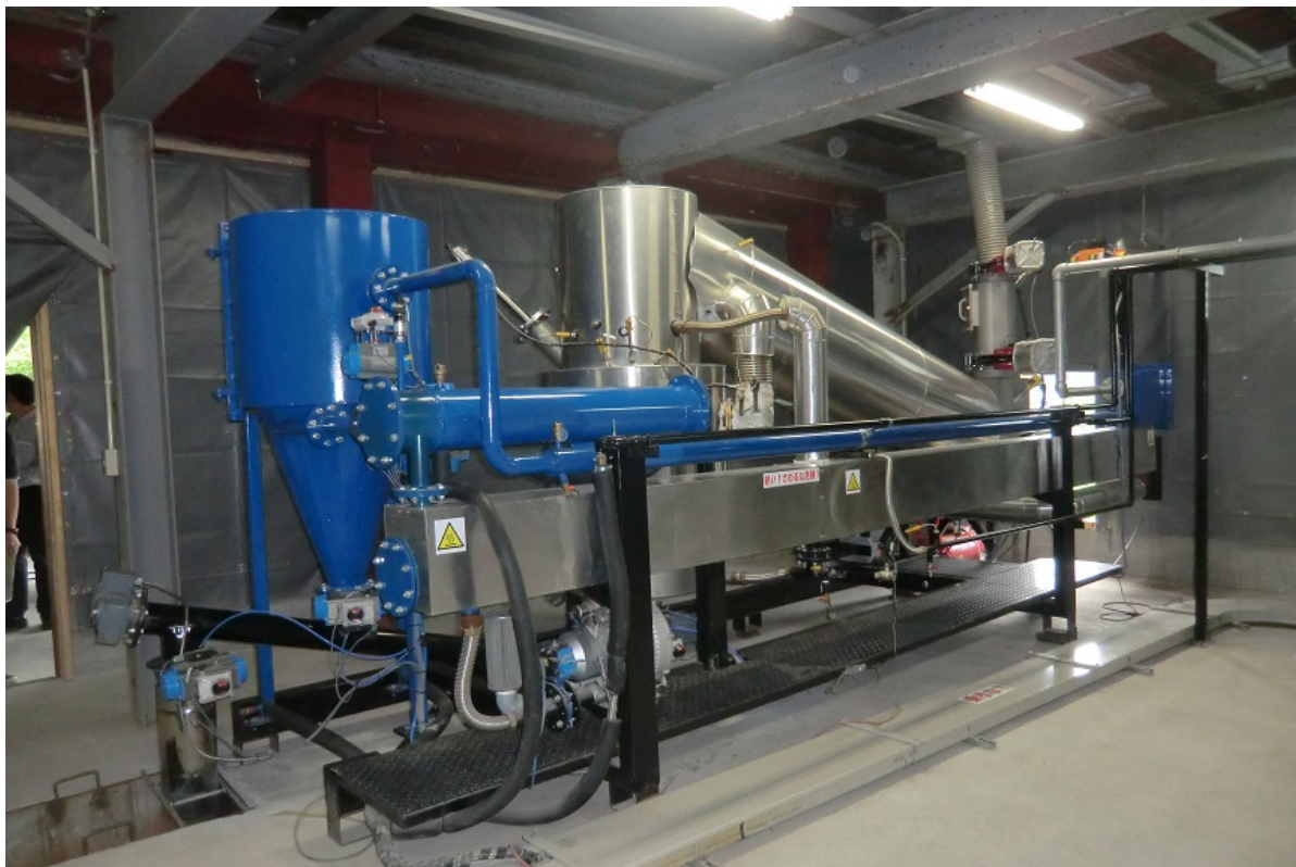
LiPRO ガス化装置の顧客先設置稼働写真
