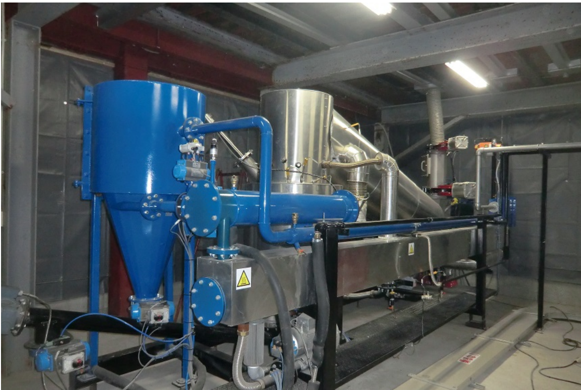
中央部の斜めの円筒部分が熱分解炉 (Pyrolysis) 工程であり、内部機構は上記 Viking 法の水平部と全く同じ構造です。配管の周りに高温合成ガス (SynGas) を
